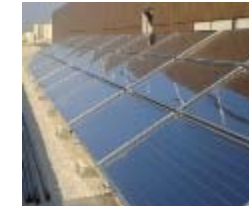
Climatisation et eau chaude solaire 120 MWh / an
